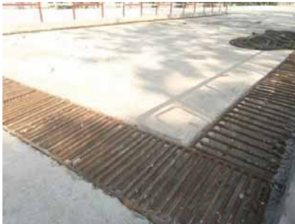
图 7.15 洗车池排水沟及沉砂池
