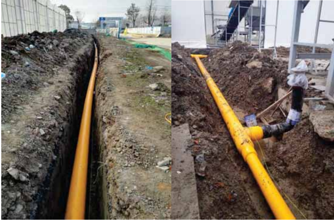
图 8.6 管道敷设实物参考图
