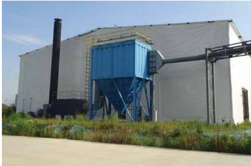
图 6.28 污染土壤修复车间尾气处理装置
