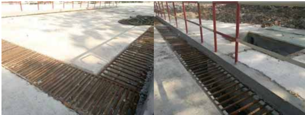
图 7.18 洗车池排水沟及沉砂池实物图
