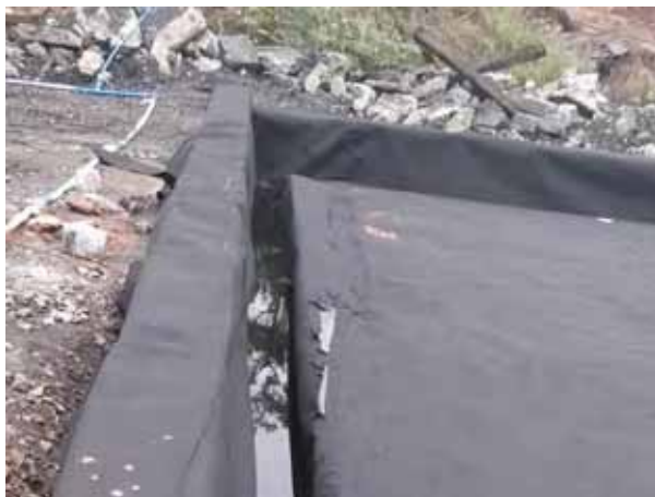
图 7.16 污染渣土堆置场地排水边沟
