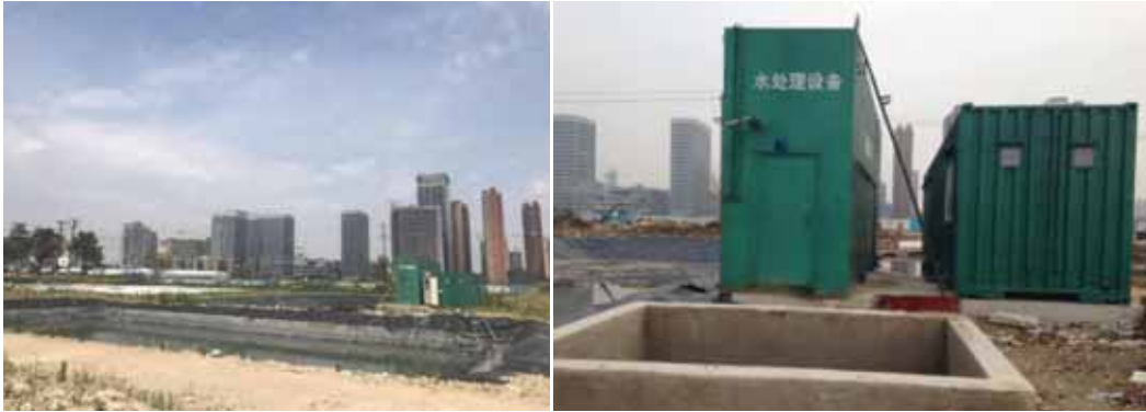
图 6.14 污水处理实物图
